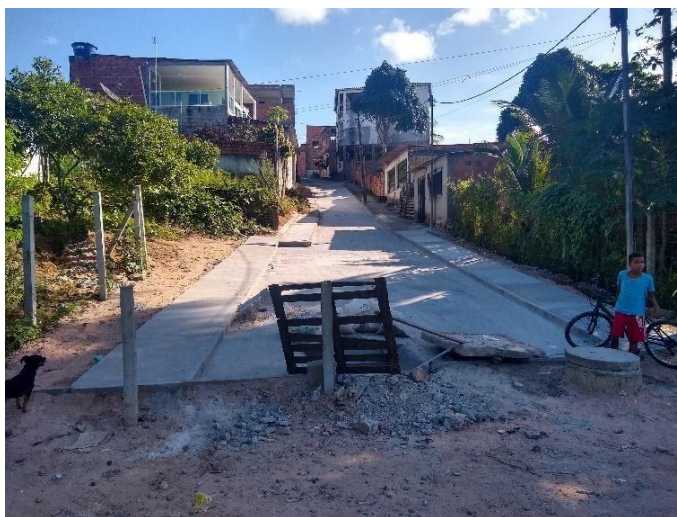
Figura 1. Via pública como canal de escoamento de águas pluviais e resíduos – Nova Esperança - 2020
